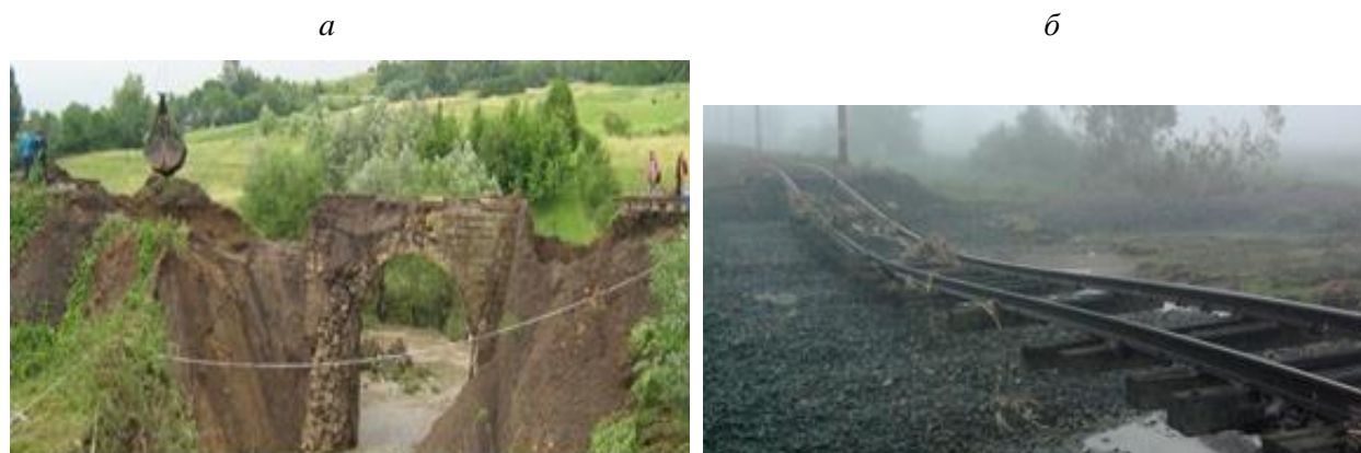
Рис. 3. Дефекти споруд в експлуатації: а) руйнування кам'яного аркового моста; б) розмив насипу залізничної колії під час паводку
